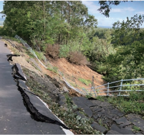
大きく陥没した道道10号線
