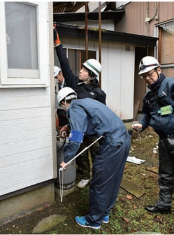
他自治体の応援職員による建物被害調査
