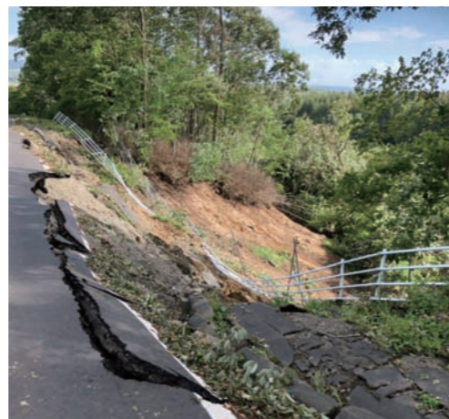
大きく陥没した道道10号線
