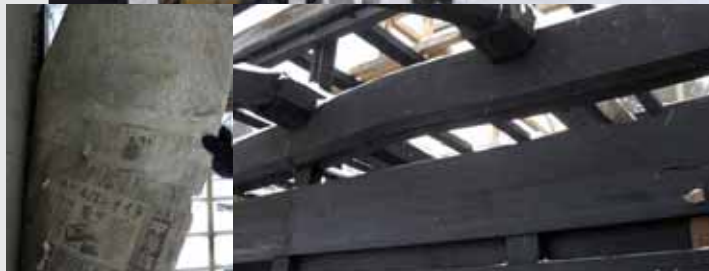
壁の裏から明治42年11月発行の新聞（左）家屋を支える見事な梁組み
