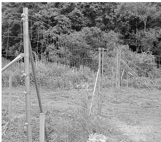
高丘地区に設置された金網フェンス
