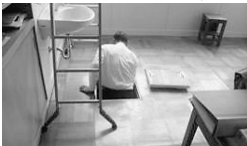
水落としのために床下に潜る教員 (3カ所の床下に潜らなければならない、手前のはしごは天井裏のバルブを開めるためのもの)
