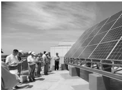
中央小学校に設置したソーラーパネル
