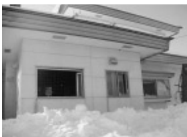
窓ガラスも割れ、危険な廃屋
