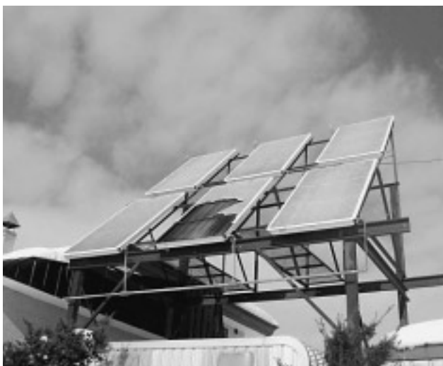
屋上に設置されている太陽熱温水器が見直されている
