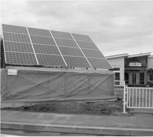
つみきに設置された太陽光パネル
