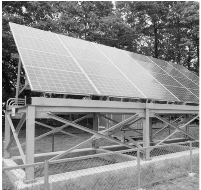
6カ月間で4万円分の発電をした上厚真小学校の太陽光発電施設
