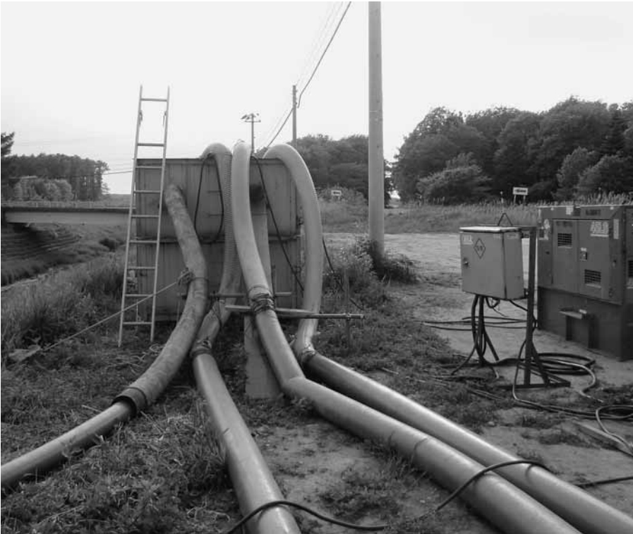
軽舞地区に設置された送水中継点
