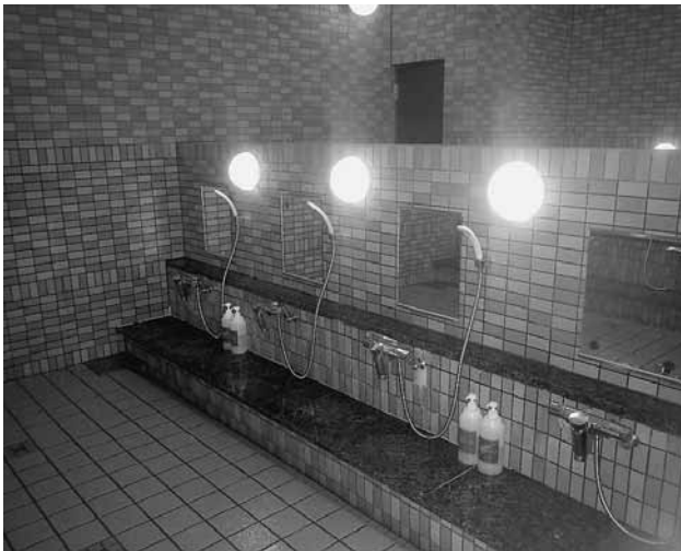
浴室の配管は劣化が激しく早急の改修が必要
