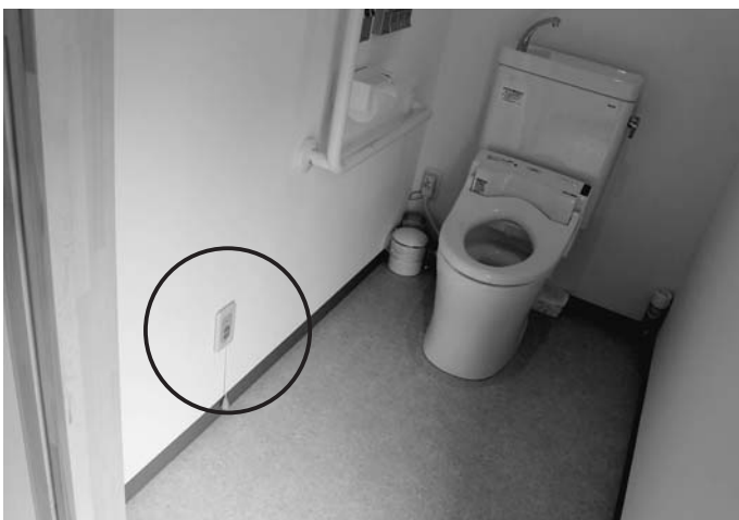
トイレの下方に設置されている緊急用ボタン
