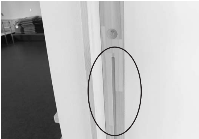
引き戸の溝が浅く、手がかけづらい形状となっている
