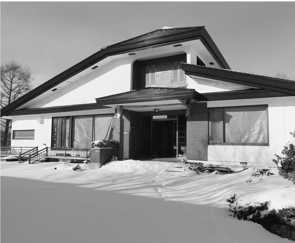
地震によって窓ガラスが割れ、全壊判定を受けた住宅
