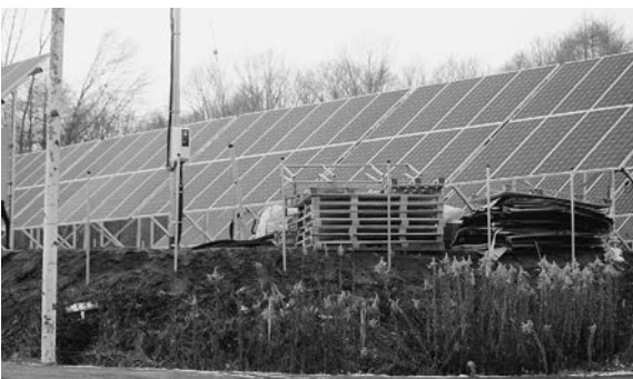
設置された太陽光パネル
