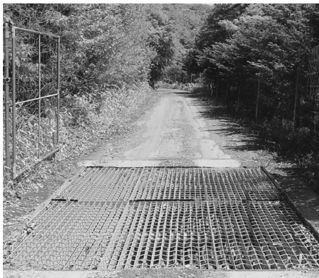
H 29 に設置された鹿侵入防止グレーチング（豊丘地区）
