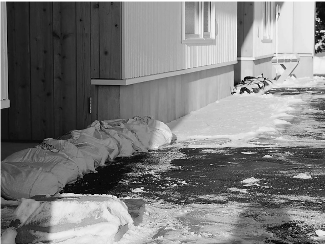
水の流入があった災害公営住宅
