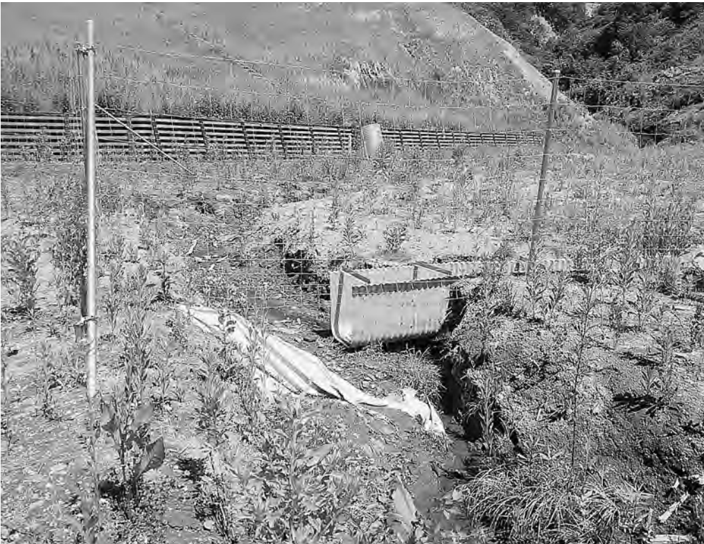
決壊した排水溝
