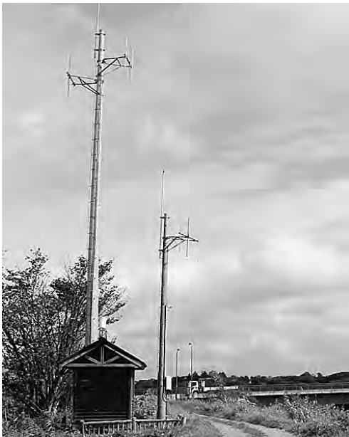
河川情報システム厚真大橋水位雨量計
