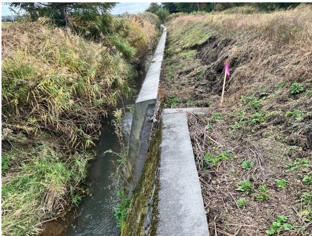
・チケッペ川護岸倒伏状況
