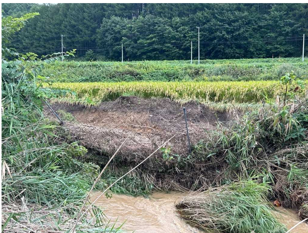
・準用河川ハビウ川⑤ 河岸欠壊状況
