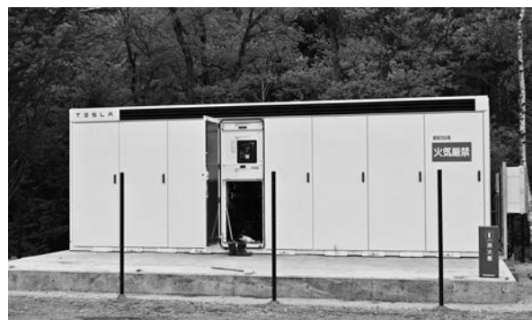
本郷福祉施設跡地に設置された蓄電池
