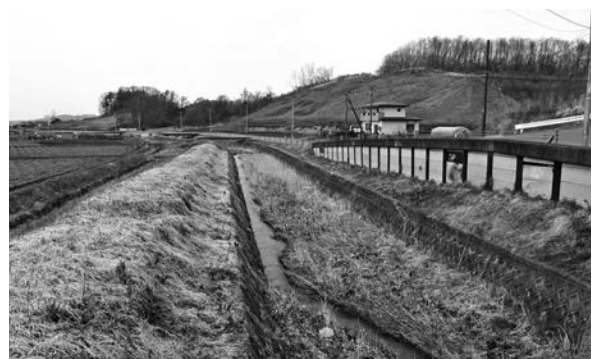
堆積土砂などの撤去を行うチカエップ川
