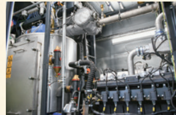
コンテナに納められた木質バイオマス発電設備
