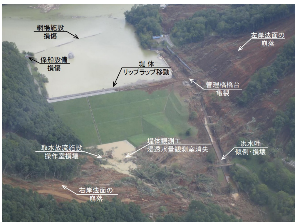
被災直後の厚真ダムの状況写真
