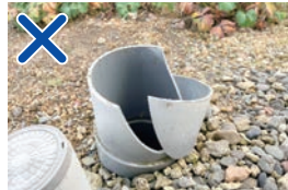
破損している
