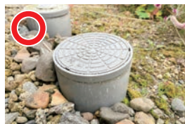
正常な污水管点検口
