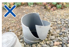
破損している
