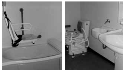
介護実習用の風呂やトイレ、洗面台
