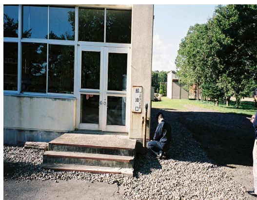
C 中学校の建物の沈下
