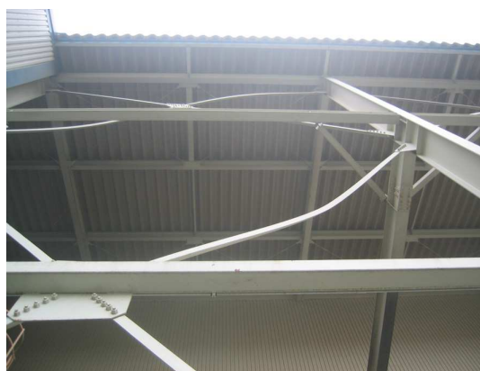
B 倉庫の筋交いの座屈
