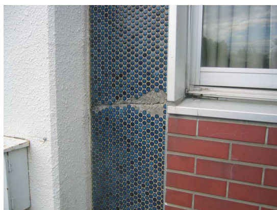
A 会館の袖壁の損傷
