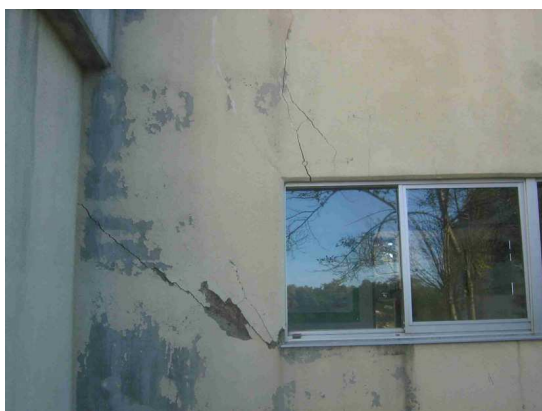
C 中学校の壁のひび割れ
