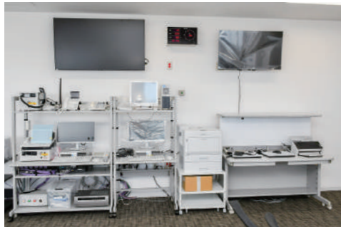
通信機器等を備えた事務所
