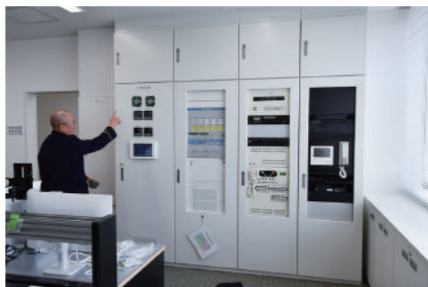
中央監視装置や防災監視盤
