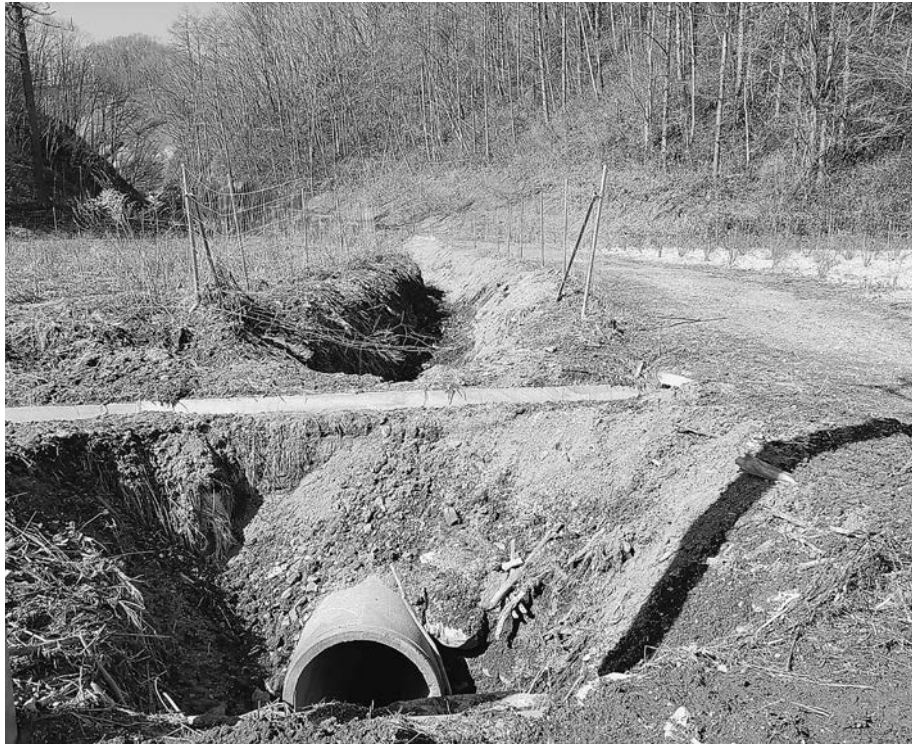
大雨で損壊した排水路
